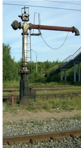
Фото 27. Так выглядела водокачка. Слева вентиль подачи воды
